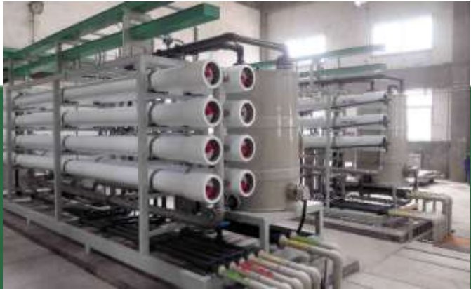
某印染公司污水零排放
