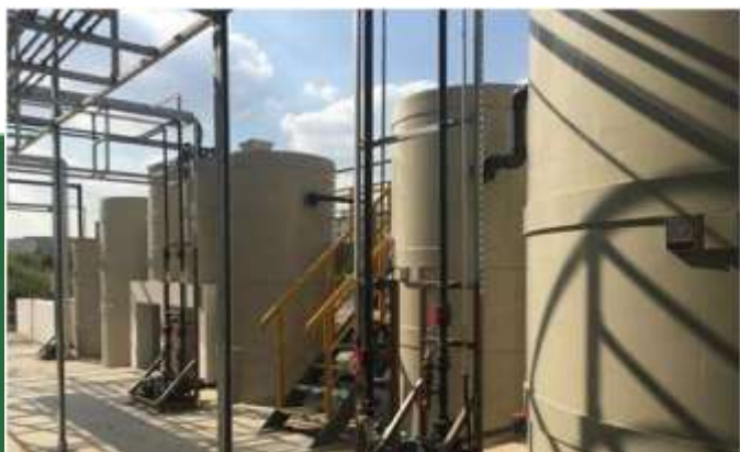
某焦化废水深度处理
