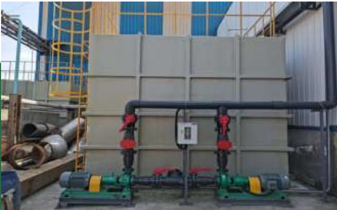
RO浓缩废水零排放
