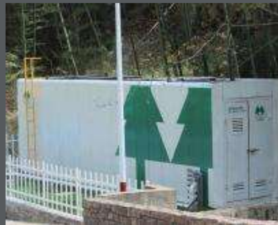
湖州市安吉县污水处理终端
